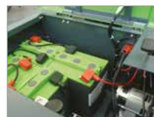
ALOJAMIENTO DE BATERÍAS (1250 E)
