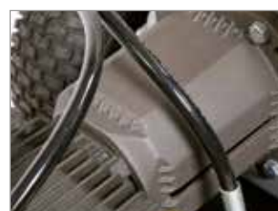
VÁLVULA TERMOSTÁTICA PARA PROTEGER LA BOMBA DE UN POSIBLE RECALENTAMIENTO DURANTE EL BY-PASS
