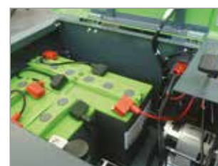
ALOJAMIENTO DE BATERÍAS (1250 E)
