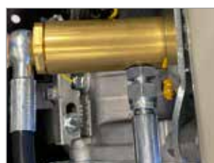
ACOPLAMIENTO FLEXIBLE ENTRE BOMBA Y MOTOR
