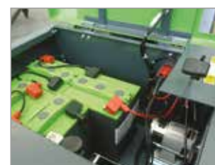
ALOJAMIENTO DE BATERÍAS (1280 E)
